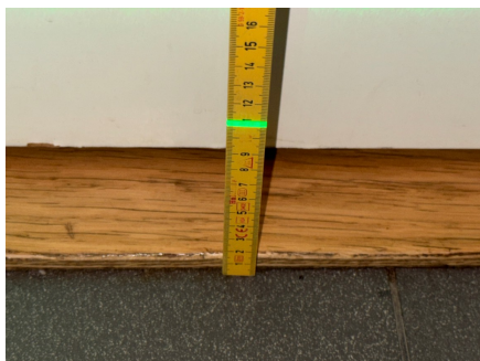
Fallforhold ca. 110 mm overkant gulv ved terskel
