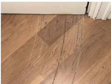
Parkettgulvet foran entrédøren har skade/riper
