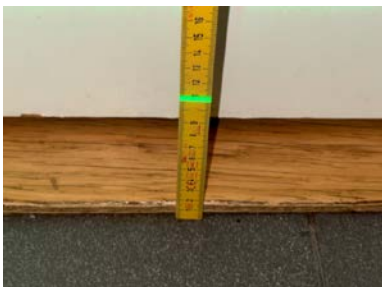
Fallforhold ca. 110 mm overkant gulv ved terskel
