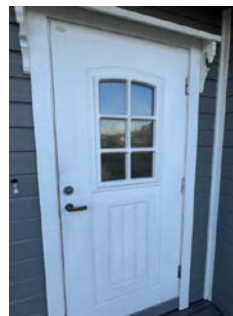
Ytterdør fra byggeår, utskiftning må påberegnes på sikt
