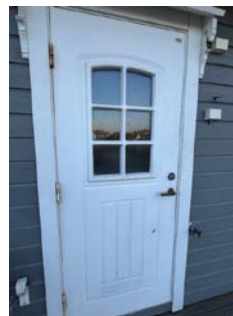
Boddør fra byggeår, utskiftning må påberegnes på sikt
