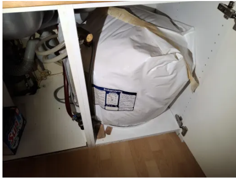
Varmtvannsberederen er plassert i kjøkkeninnredningen.
