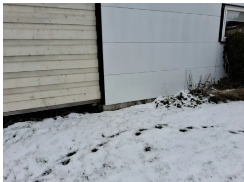
Fundamenteringen er ikke tilgjengelig for inspeksjon.
