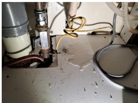
Det registreres en mindre vannsamling i kjøkkeninnredning.
