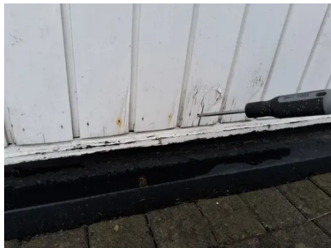
Det registreres råteskader i boddør.
