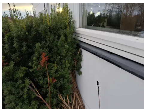
Busk vokser tett mot vindu og fasade.
