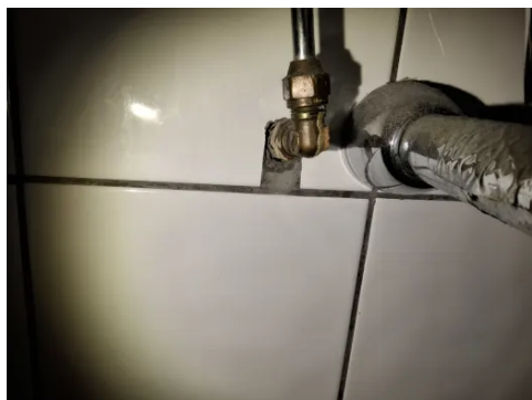
Det registreres utettheter ved rørgjennomføring i vegg til servant.
