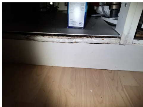
Det registreres svelleskade i bunnplate på kjøkkeninnredning.
