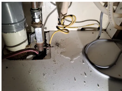
Det registreres en vannsamling i kjøkkenskap, stoppekran virker ikke som tiltenkt.
