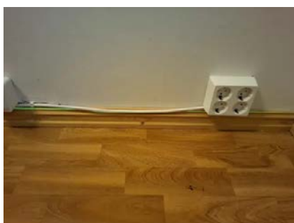
Det registreres løs en løs kabel på soverom.
