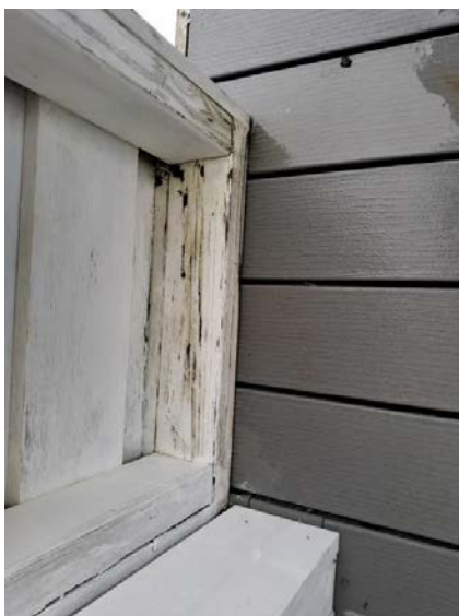
Avflasket maling på levegg.
