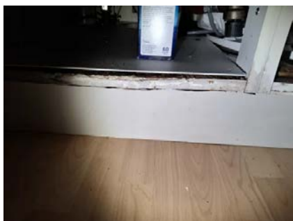
Det registreres svelleskade i bunnplate på kjøkkeninnredning.
