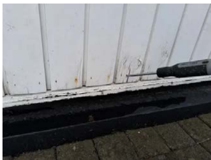
Det registreres råteskader i boddør.
