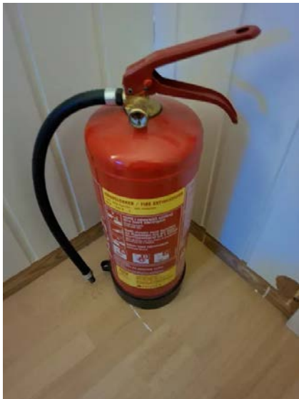
Det er over ti år siden brannslukningsapparat ble kontrollert.
