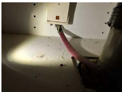
Det mangler noe isolering på kabel til bryter i kjøkkeninnredning.
