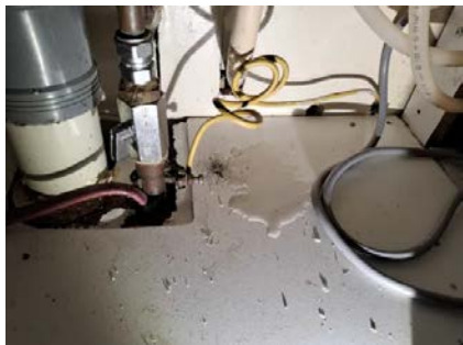
Det registreres en mindre vannsamling i kjøkkeninnredning.
