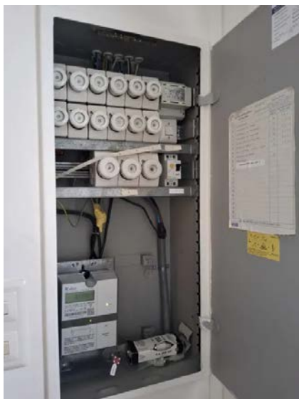
Sikringsskap med skrusikringer er plassert i entré.
