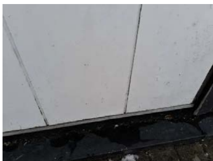
Entrédør er slitt og viser tegn til utvendig oppfukting.
