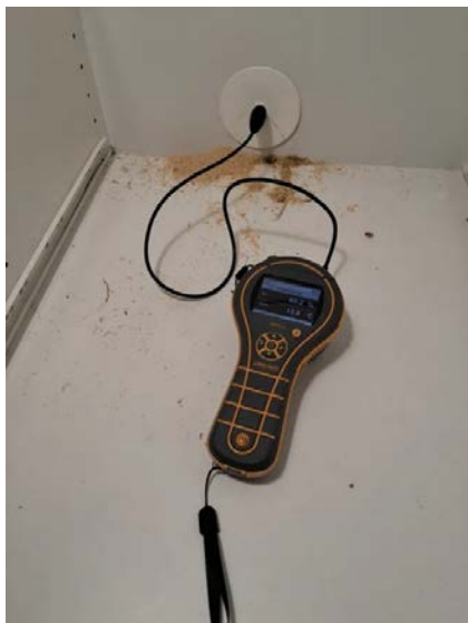
Bilde fra fuktmåling i veggkonstruksjon tilstøtende våtsone.
