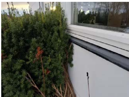
Busk vokser tett mot vindu og fasade.
