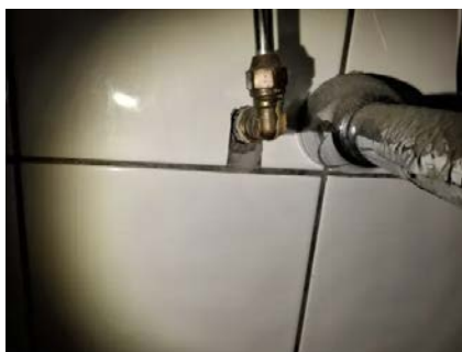
Det registreres utettheter ved rørgjennomføring i vegg til servant.
