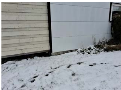
Fundamenteringen er ikke tilgjengelig for inspeksjon.
