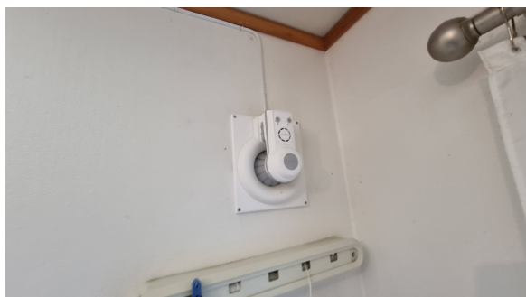
Elektrisk styrt avtrekksvifte.
