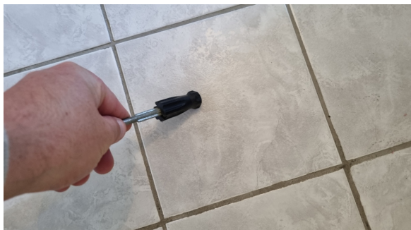
Det ble registrert bom i flis.
