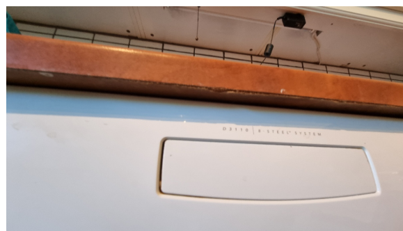
Fuktsvell i benkeplate over oppvaskmaskin
