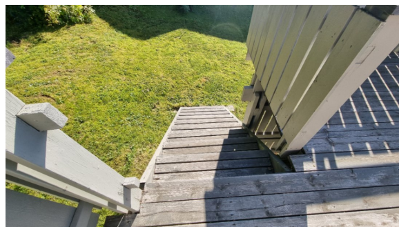
Trapp mangler rekkverk.
