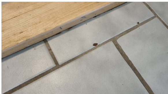
Sår/hakk i fliser i 1. etasjen, samt at det er bom i enkelte fliser
