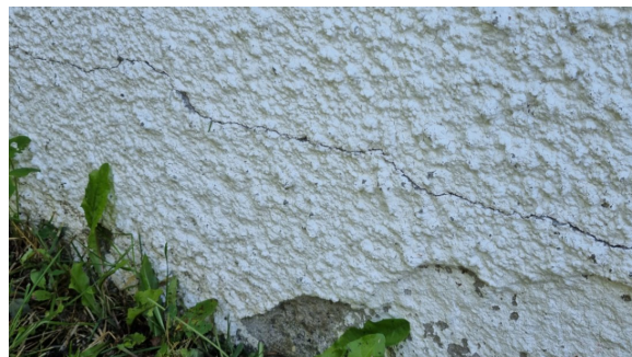
Stedvis sprekker i utvendig puss.
