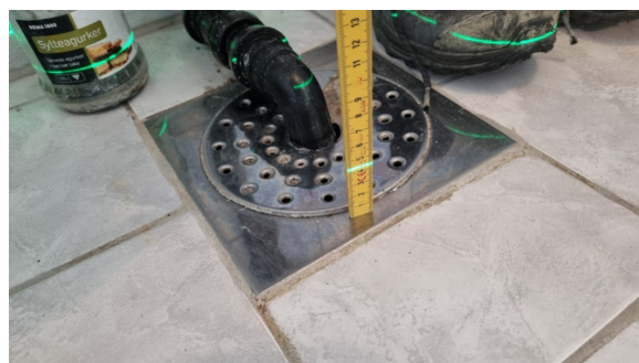
Det er påvist at høydeforskjell fra topp slukrist til gulv/synlig topp membran ved dørterskel er mindre enn 25 mm.
