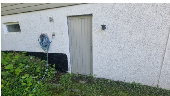
Dør til bod har store svekkelser.
