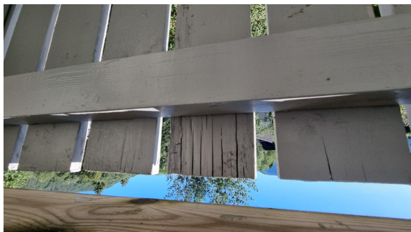
Terrassen har råteskadet rekkverk.
