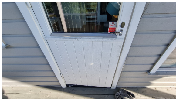
Balkongdør er værslitt.
