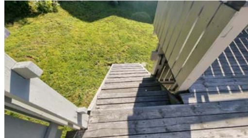
Trapp mangler rekkverk.
