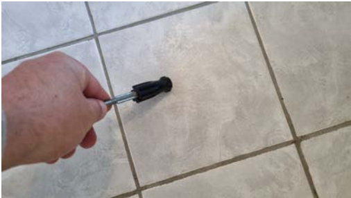
Det ble registrert bom i flis.
