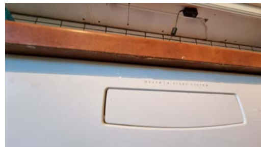
Fuktsvell i benkeplate over oppvaskmaskin
