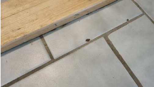
Sår/hakk i fliser i 1. etasjen, samt at det er bom i enkelte fliser
