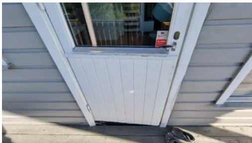
Balkongdør er værslitt.
