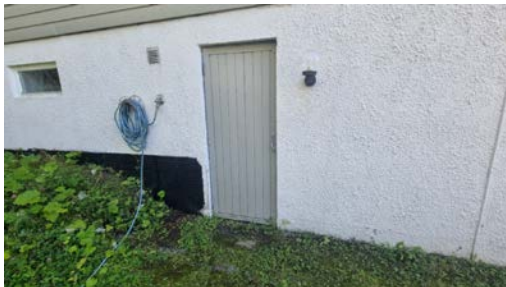
Dør til bod har store svekkelser.
