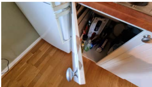
Skade i skapdør.
