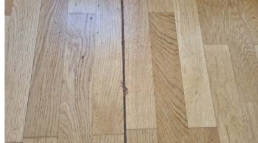
Sprekk og noe overflateslitasje i parkett.
