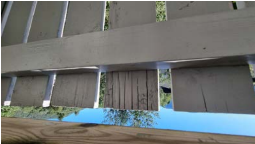
Terrassen har råteskadet rekkverk.
