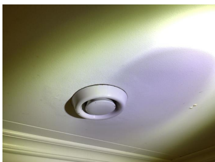
Noe skjolder rundt ventil.
