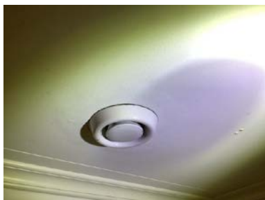
Noe skjolder rundt ventil.
