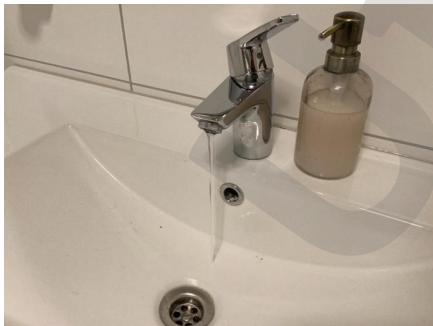
Dårlig vanntrykk i kran på bad i loftsetasje.
