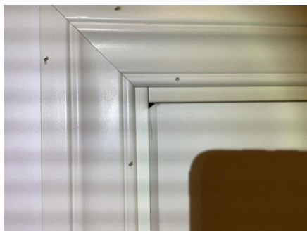
Dør til bod på loftsetasje tar litt i karm.
