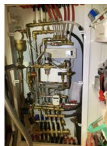
Stoppekran lokalisert i fordelersskap på teknisk rom.
