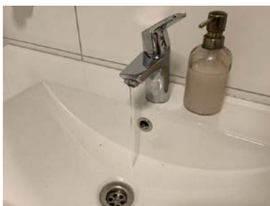
Dårlig vanntrykk i kran på bad i loftsetasje.
