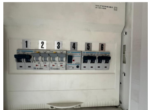
Sikringsskap med automatsikringer.
