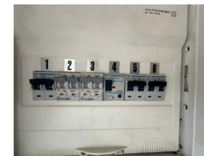
Sikringsskap med automatsikringer.
