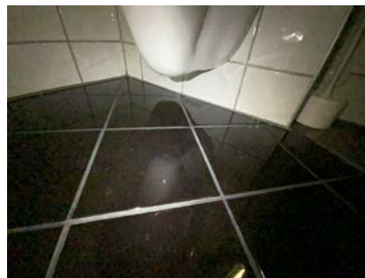
Lekkasjespalte på innebygget systerne bør opparbeides.
