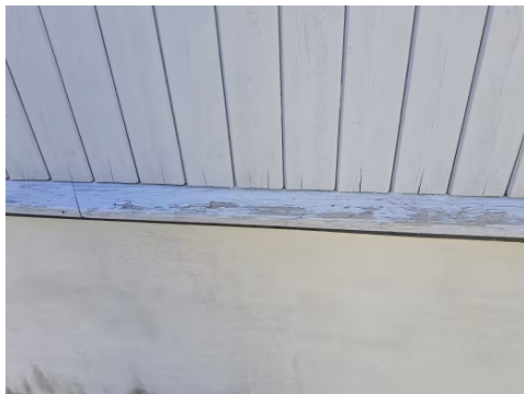
Deler av kledningen er værslitt og oppsprukket.
