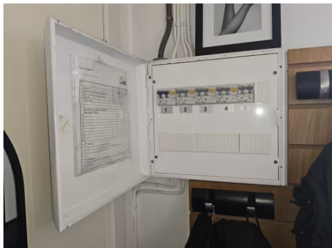
Sikringsskap er plassert i entré.
