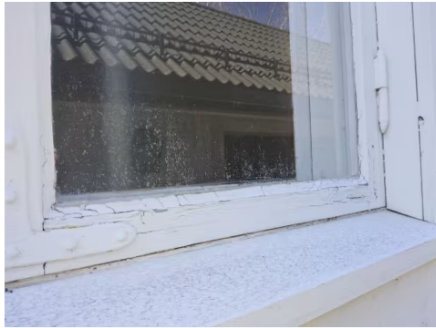
Vinduer er værslitte og har sprekker i kittfalsler.
