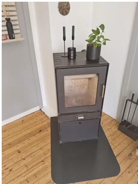
Vedovn med glassdør i stue.
