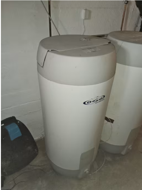
Varmtvannsbereder er plassert i kjeller.
