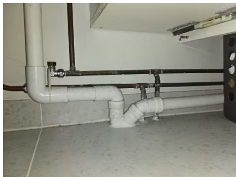
Synlige avløpsrør av plast i leiligheten.
