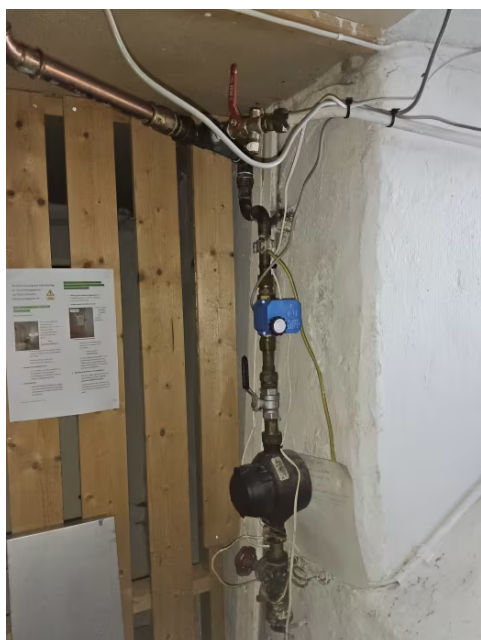
Felles stoppekran i kjeller.
