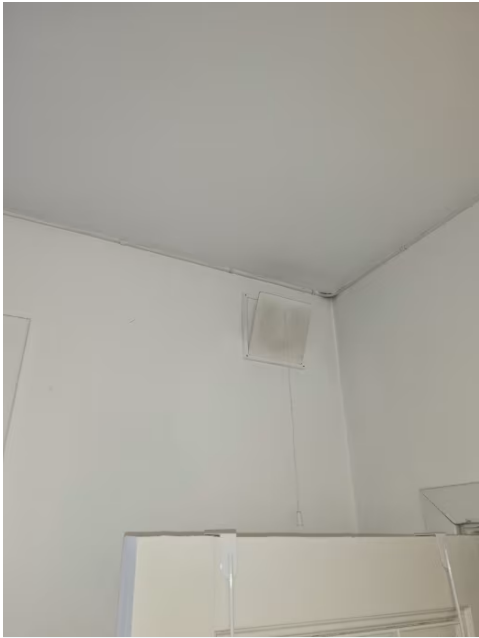
Klaffventil på yttervegg.
