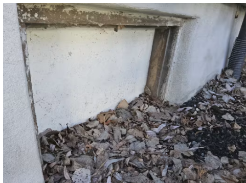
Rester av vinduskarm i grunnmuren.
