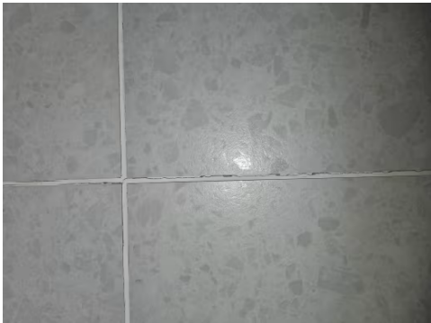
Bilde viser sprekker i flisfuger.
