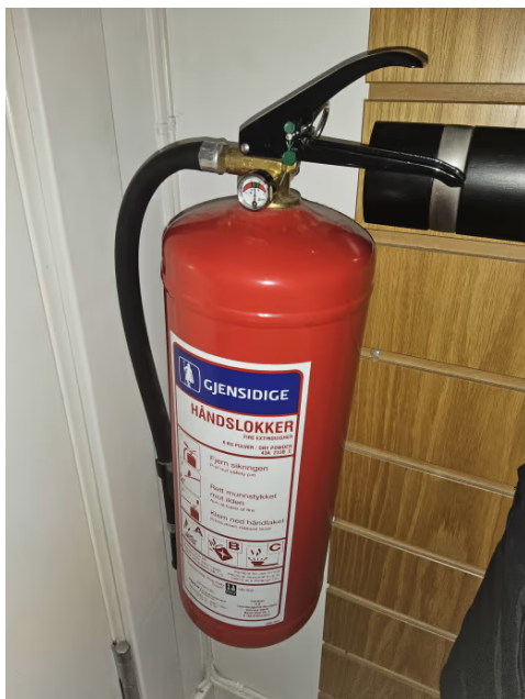
Vegghengt brannslukningsapparat ved
