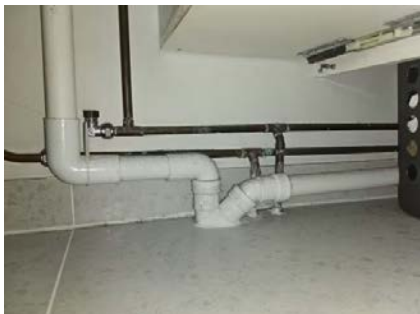
Synlige avløpsrør av plast i leiligheten.
