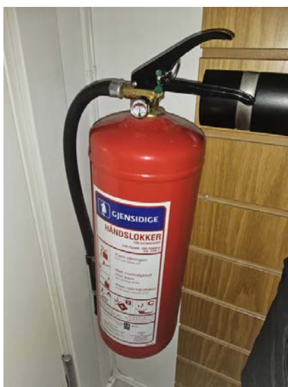
Vegghengt brannslukningsapparat ved
