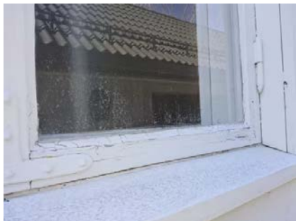
Vinduer er værslitte og har sprekker i kittfalsen.
