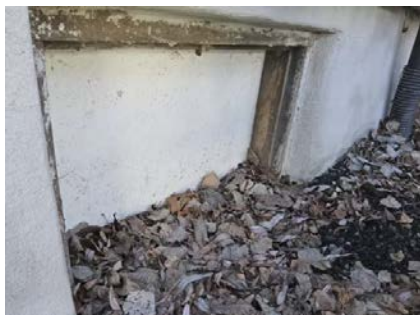
Rester av vinduskarm i grunnmuren.
