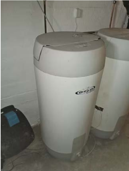
Varmtvannsbereder er plassert i kjeller.
