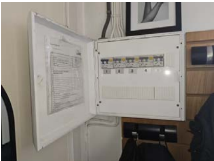
Sikringsskap er plassert i entré.
