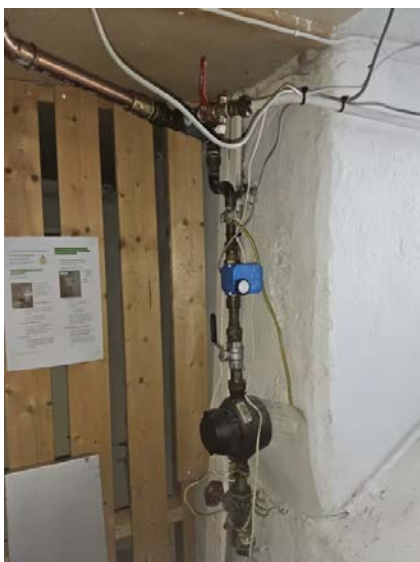
Felles stoppekran i kjeller.
