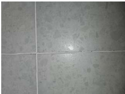
Bilde viser sprekker i flisfuger.
