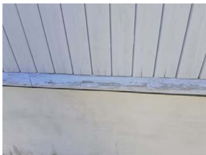
Deler av kledningen er værslitt og oppsprukket.
