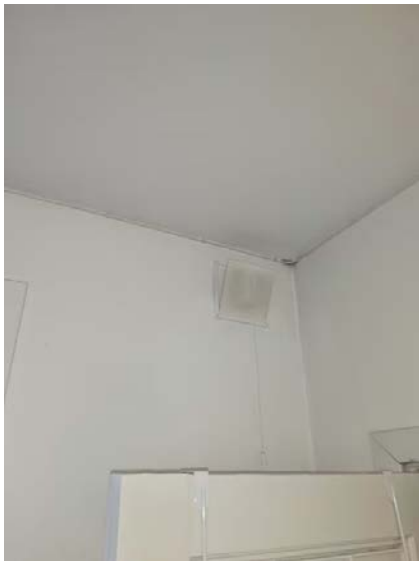
Klaffventil på yttervegg.
