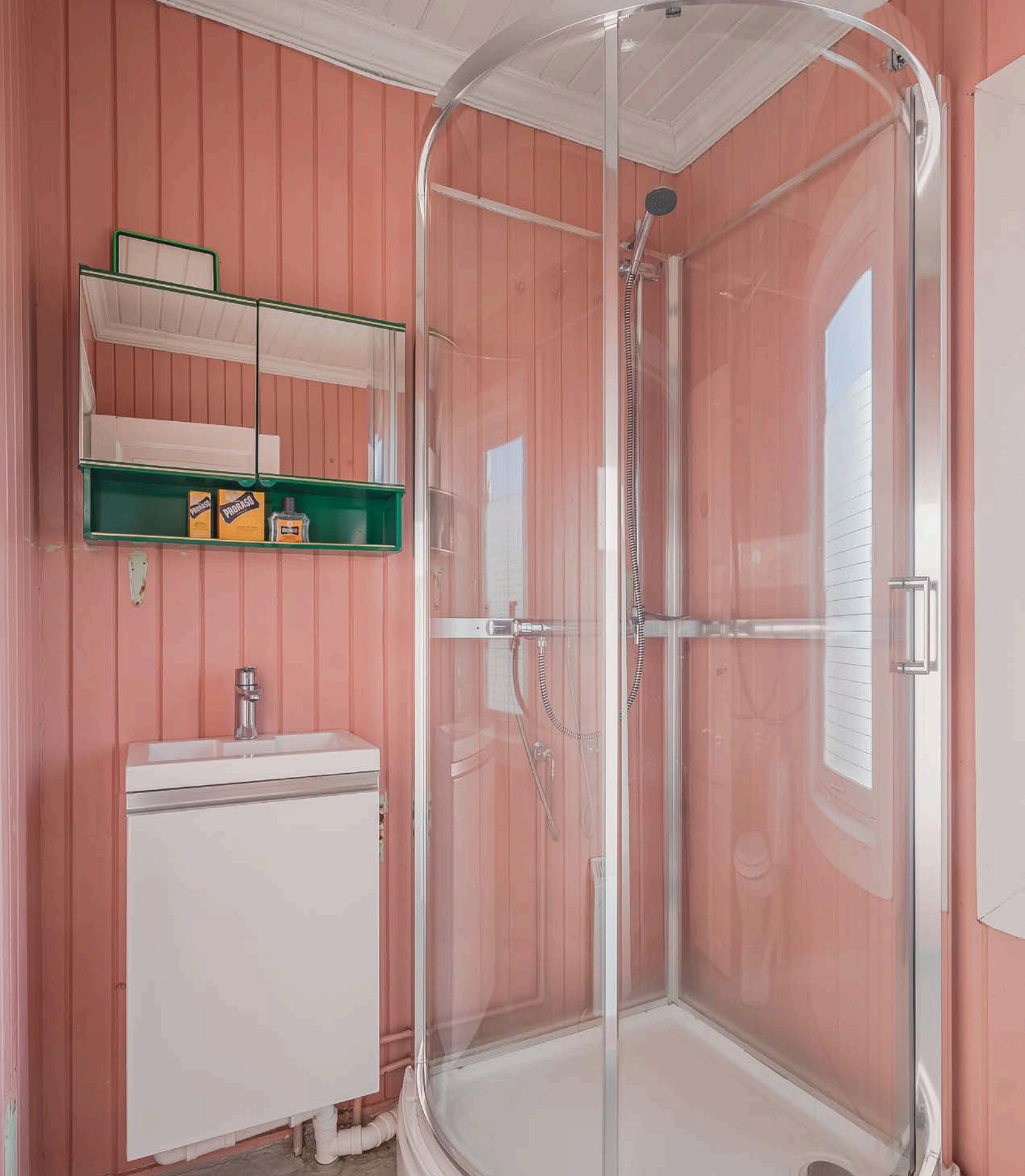
Eldre baderom i 2. etasje med fliser på gulv og overflater med malt panel. Montert dusjkabinett i 2019 som hindrer direkte vannsprut på overflatene, men baderommet må oppgraderes for å tåle normal bruk etter dagens krav.
