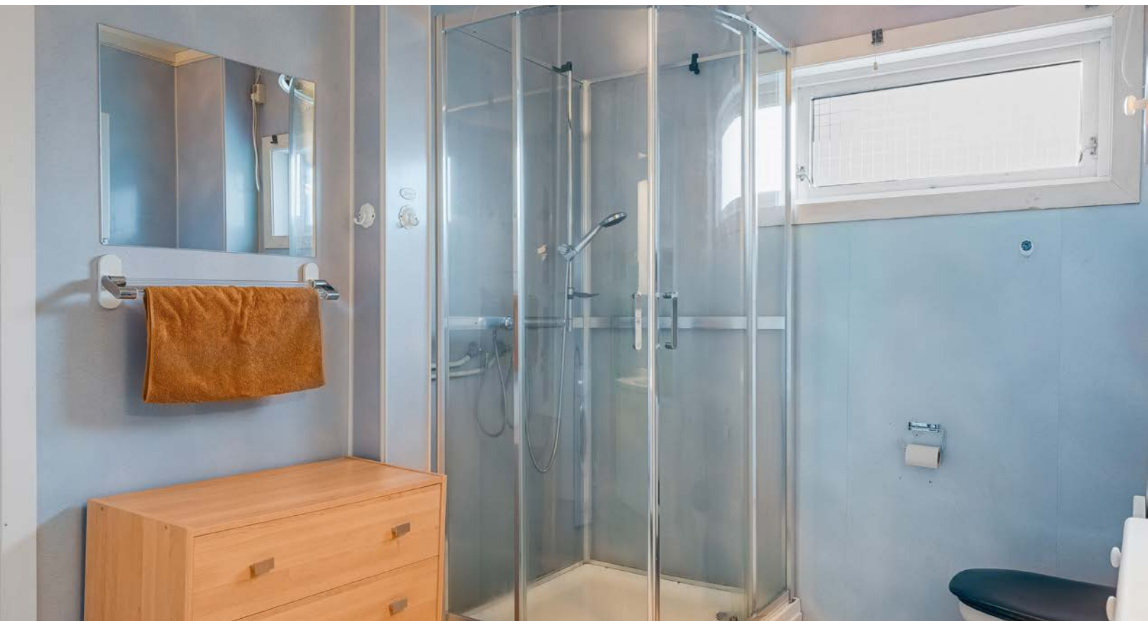
Montert dusjkabinett i 2019 som hindrer direkte vannsprut på overflatene, men baderommet må oppgraderes for å tåle normal bruk etter dagens krav.
