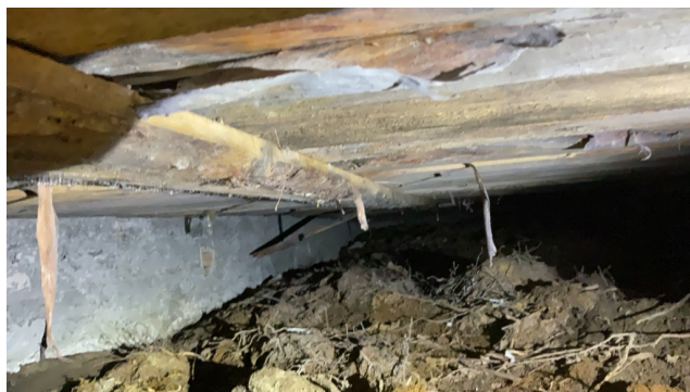
Synlig muggslør på stubbeloft
