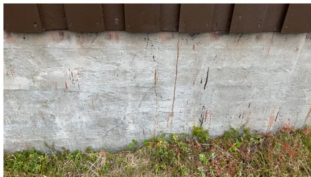
Sprekkdannelse i mur
