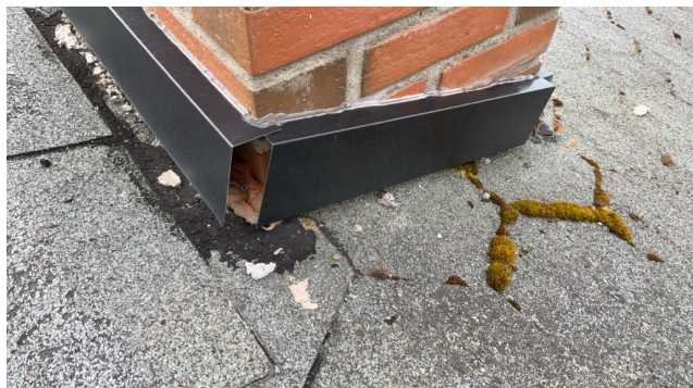
Manglende fotbeslag og bør etableres for tilstrekkelig overgang pipe og tekking
