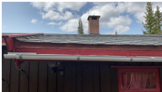
Skjevhet i tak, årsakssammenheng med fundamenteringsmetode/grunnforhold
