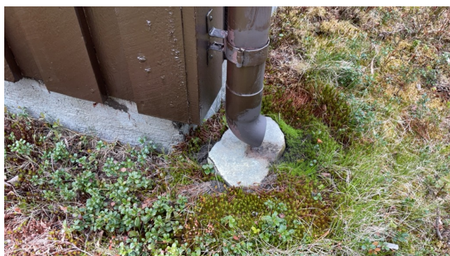
Anbefaler bortledning av takvann vekk fra bygningskropp
