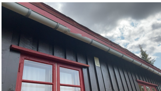
Skade på takrenne, må skiftes
