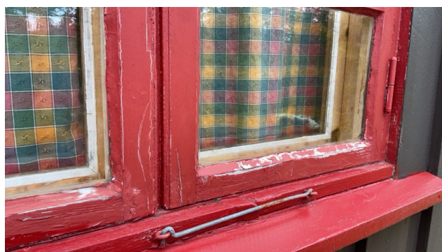
Vinduer er fra byggeår, må hensyntas alder og vedlikeholdsetterslep
