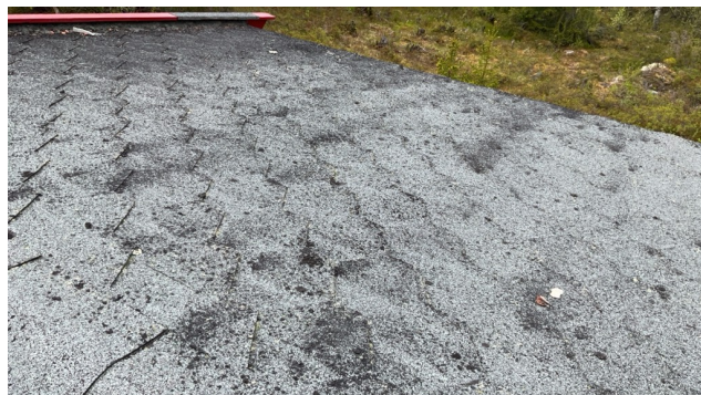
Slitasje på takteking
