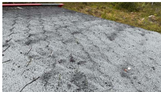
Slitasje på takteking
