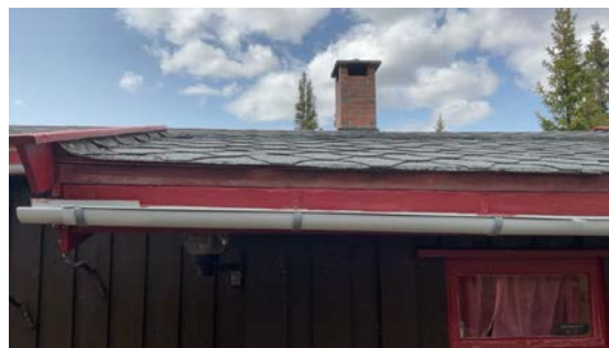
Skjevhet i tak, årsakssammenheng med fundamenteringsmetode/grunnforhold
