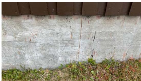
Sprekkdannelse i mur
