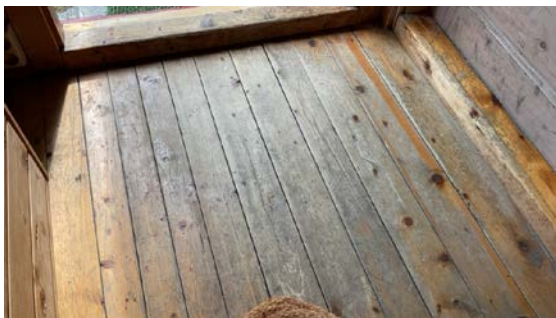
Slitasje på overflater, gulv har behov for slip/overflatebehandling
