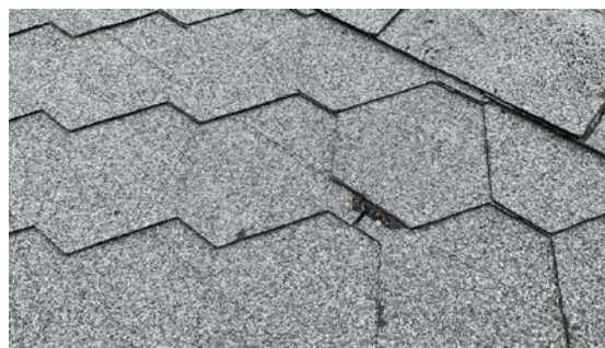
Synlig slitasje med dels dråpe på shingel avrevet, må hensyntas alder
