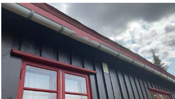
Skade på takrenne, må skiftes
