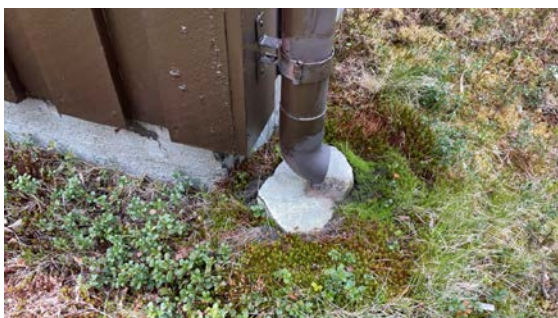
Anbefaler bortledning av takvann vekk fra bygningskropp
