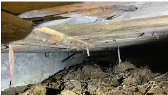
Synlig muggslør på stubbeloft
