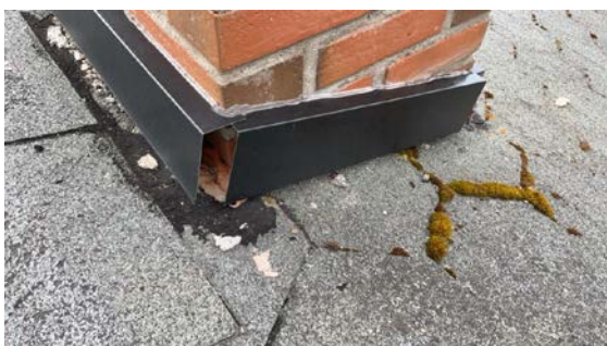
Manglende fotbeslag og bør etableres for tilstrekkelig overgang pipe og takking
