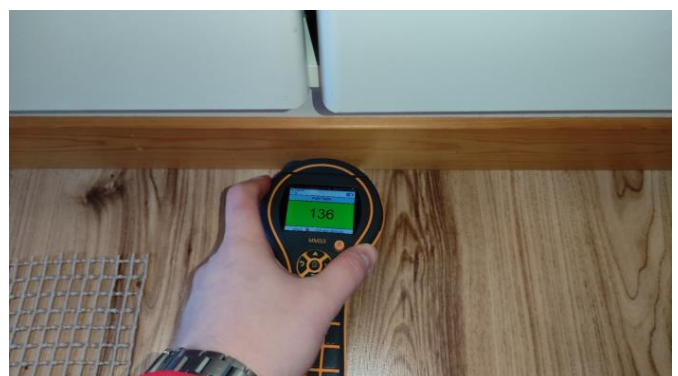
Fuktsøk ved oppvaskkum.
