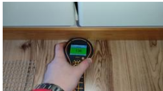
Fuktsøk ved oppvaskkum.
