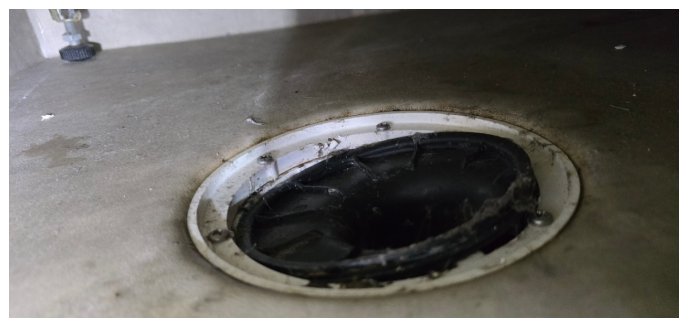
Plast sluk under dusjkabinett
