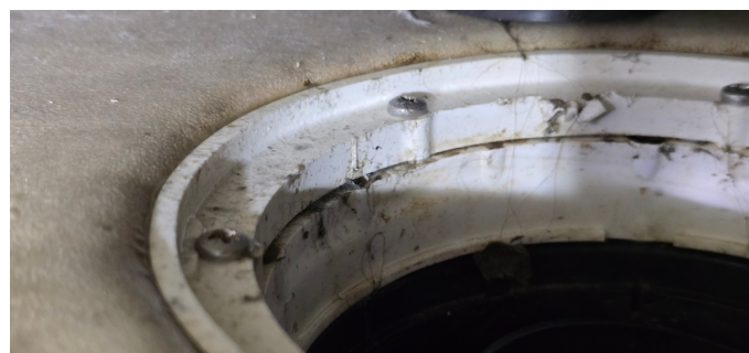
Ikke synlig belegg/membran under klem ring
