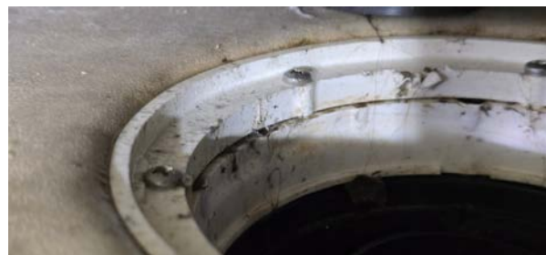
Ikke synlig belegg/membran under klem ring
