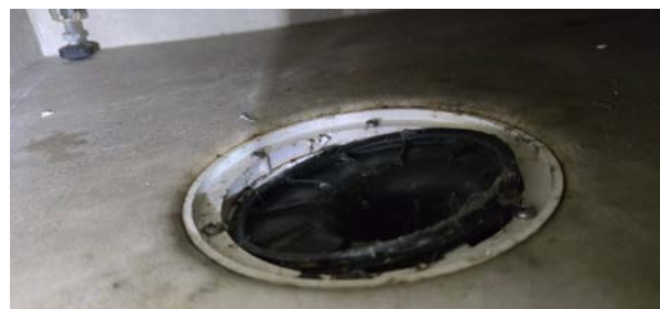
Plast sluk under dusjkabinett
