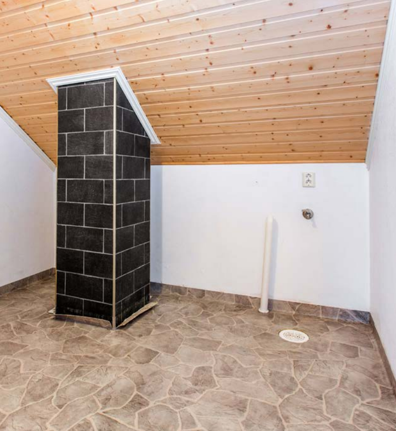
I boden på loft er det lagt opp vann og avløp for klosett, samt montert plastsluk i gulv.
