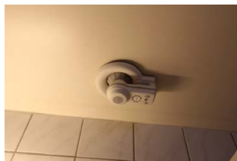
Avtrekksvifte i himlingen.
