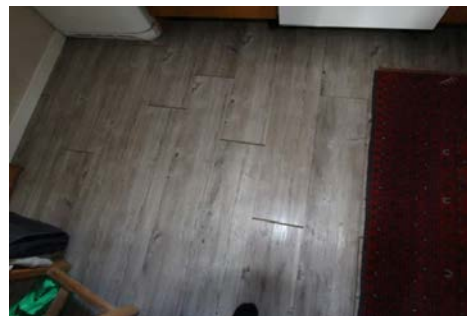
Skader på gulv.
