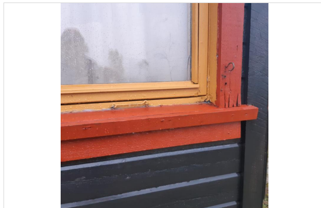
Noe røte i listverk
