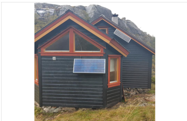
Vannbord over skråtaksvindu mangler beslag
