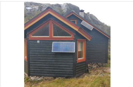
Vannbord over skråtaksvindu mangler beslag
