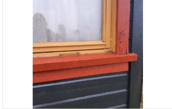
Noe råte i listverk
