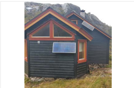
Vannbord over skråtaksvindu mangler beslag
