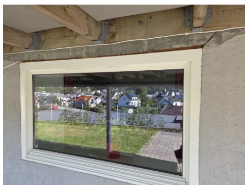
Vinduer som ikke er pusset inn.
