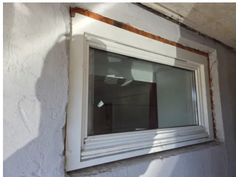
Vinduer som ikke er pusset inn.
