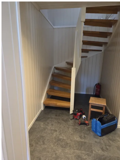
Trapp i U-etg. Håndløper mangler.
