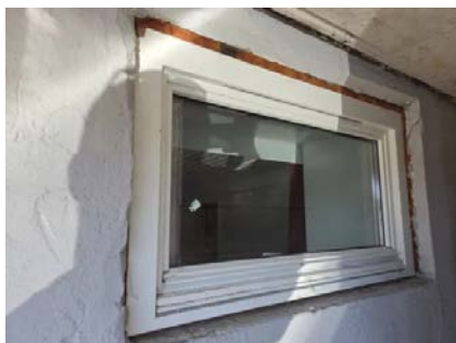
Vinduer som ikke er pusset inn.
