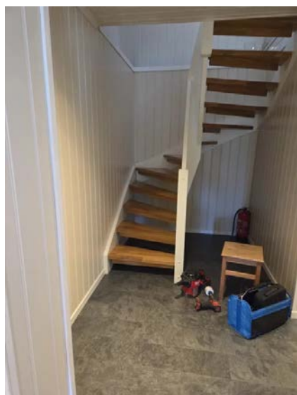
Trapp i U-etg. Håndløper mangler.
