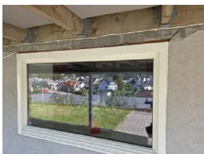
Vinduer som ikke er pusset inn.
