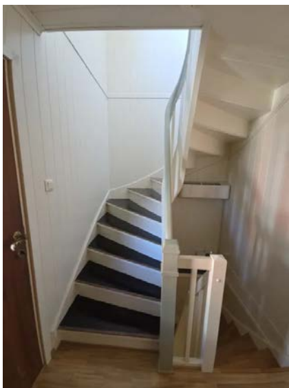
Trapp i 1.etg. Håndløper mangler.
