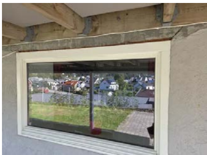
Vinduer som ikke er pusset inn.
