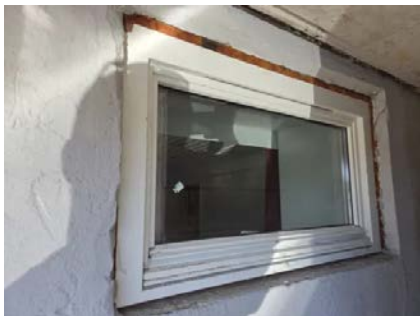
Vinduer som ikke er pusset inn.
