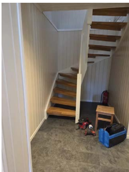
Trapp i U-etg. Håndløper mangler.
