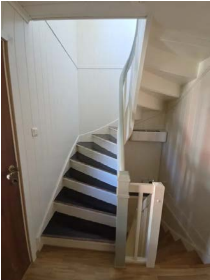
Trapp i 1.etg. Håndløper mangler.
