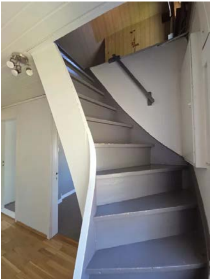
Trapp opp til høgaloft. Rekkverk og håndløper mangler.
