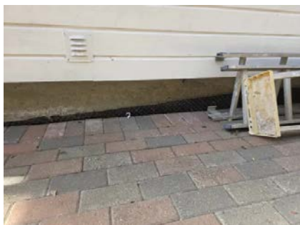
Topplist platon er ikke montert.
