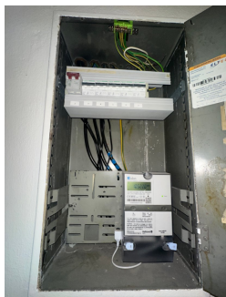
Sikringsskap med automatsikringer.
