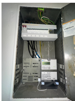
Sikringsskap med automatsikringer.
