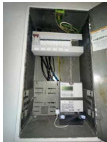
Sikringsskap med automatsikringer.
