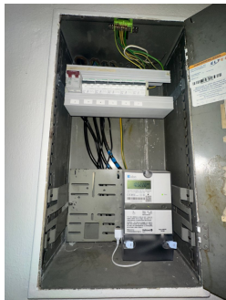
Sikringsskap med automatsikringer.
