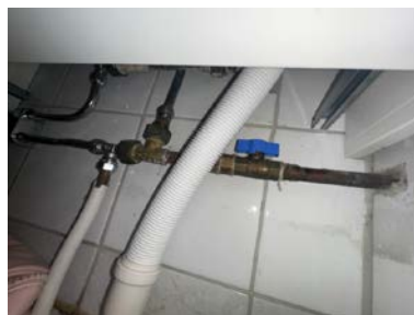
Stoppekraner plassert på bad
