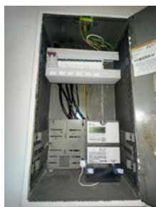
Sikringskap med automatsikringer.
