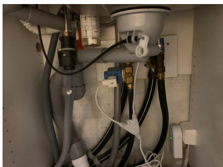
Rørapplegget i kjøkkenet
