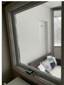
Pvc vinduer. Dette vinduet kniper litt t mot karm.
