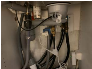
Rørplegget i kjøkkenet
