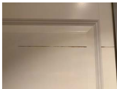
Lite skrapemerke på den ene døren. Lokal utbedring anbefales
