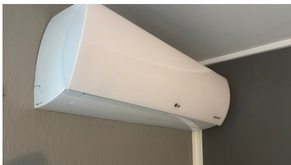
Varmepumpe på stuen
