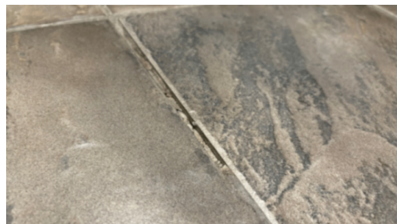
Skader i enkelte flisfuger
