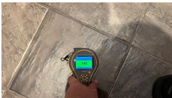
Fuktsøk uten tegn på unormale verdier
