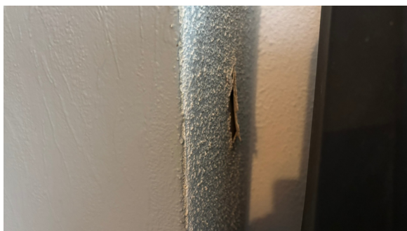
Avskalling av pussen til venstre for peisen
