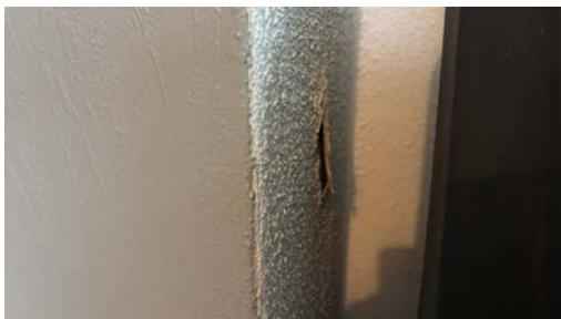
Avskalling av pussen til venstre for peisen
