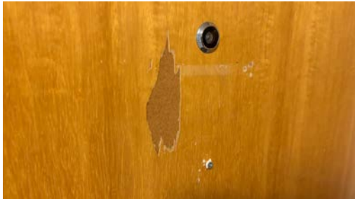
Skade på ytterdøren
