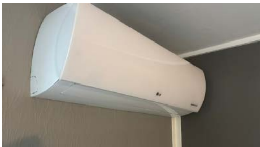
Varmepumpe på stuen
