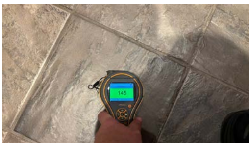
Fuktsøk uten tegn på unormale verdier
