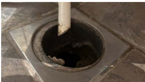
Eldre sluk i støpejern
