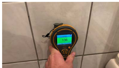
Fuktsøk uten tegn på unormale verdier
