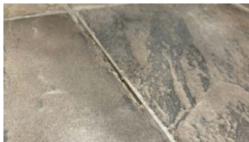
Skader i enkelte flisfuger
