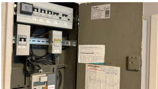
Sikringsskap i fellesareal
