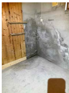
Bildet viser forekomst av saltutslag samt tegn til fuktgjennomtrengning i konstruksjonen.
