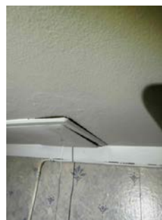
Bildet viser tegn til svelling rundt takventil.
