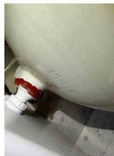
Bildet viser sprekk på undersiden av servanten.
