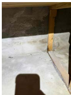
Bildet viser mugg og råteskade på hylle i kjelleren,
