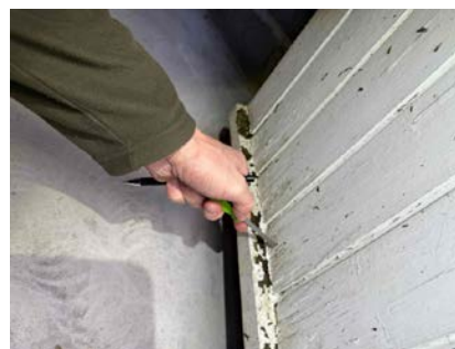
Bildet viser kjellerdør med råteskader.
