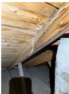
Bildet viser fuktskjolder i tilknytning til pipegjennomføringen.
