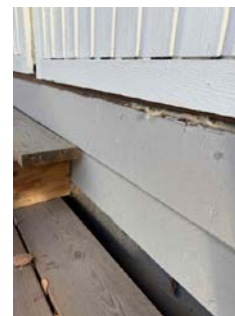
Bildet viser åpning under balkongdør uten tetting/beslag.
