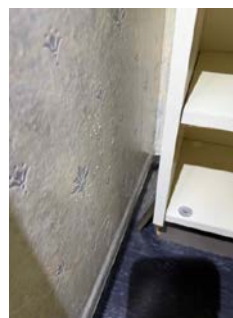
Bildet viser svelling på innredningen/skapet under servanten.
