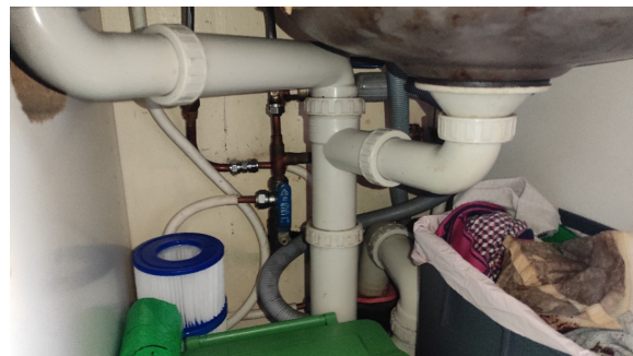
Kontroll etter lekkasjer.
