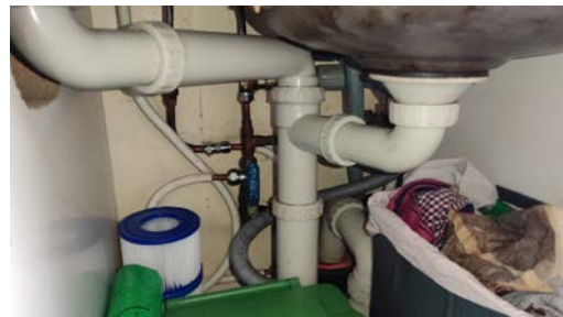
Kontroll etter lekkasjer.
