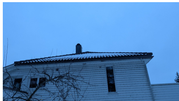
Det er ikke snøfangere.
