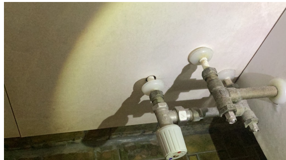
Utette gjennomføringer i våtsone.
