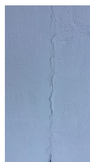
Eksempel på sprekk i grunnmur.
