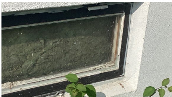
Eksempel på slitasje på kjellervindu.
