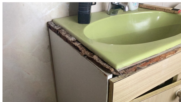
Skade på servantinnredning.
