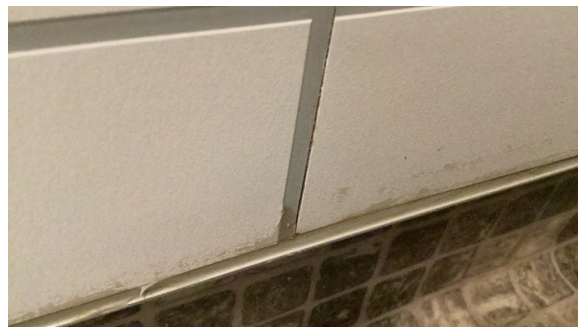
Eksempel på glippe i plateskjøt.
