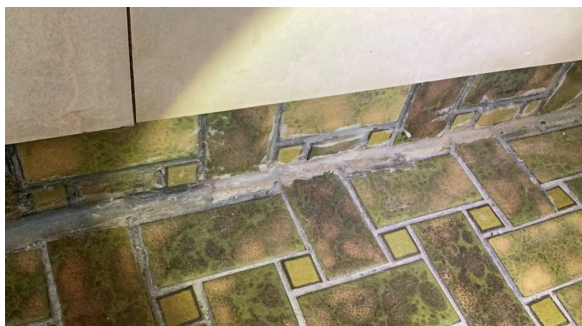
Det er oppsprekking og refuging i overgang mellom gulv og vegg.
