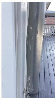
Eksempel på frostspreng på taknedløp
