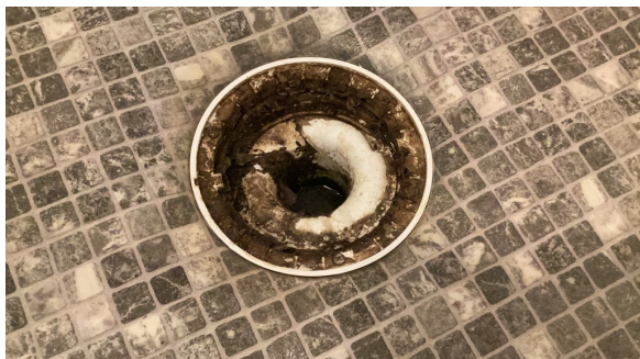
Sluk av plast med klemring.
