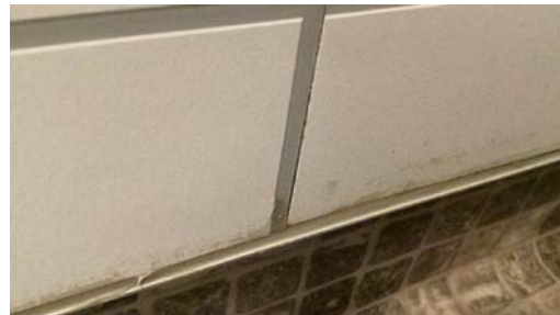
Eksempel på glippe i plateskjøt.
