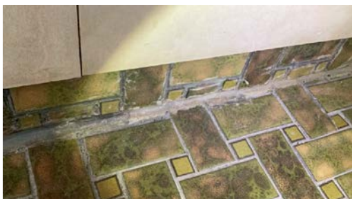
Det er oppsprekking og refuging i overgang mellom gulv og vegg.
