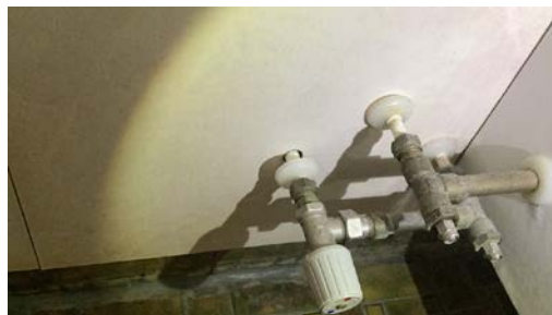
Utette gjennomføringer i våtsone.
