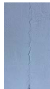
Eksempel på sprekk i grunnmur.
