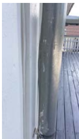
Eksempel på frostspreng på taknedløp
