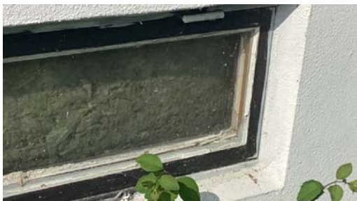
Eksempel på slitasje på kjellervindu.
