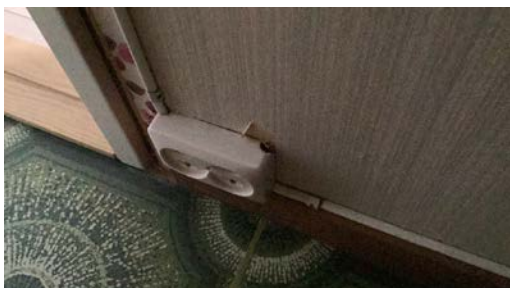
Eksempel på forhold som vil gi avvik ved en eventuell el-kontroll.
