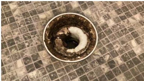
Sluk av plast med klemring.
