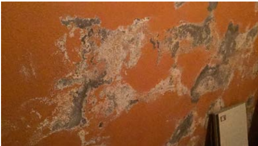
Eksempel på saltutslag og avskaling på murvegg.
